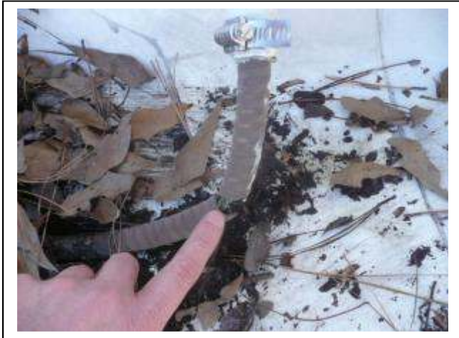
Broken/open electrical conduit
